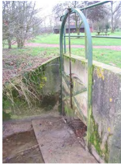
Vannage amont vers l'étang
