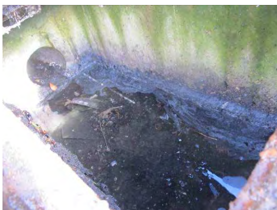
Réseau d'eaux pluviales avec pollution par des eaux grises
