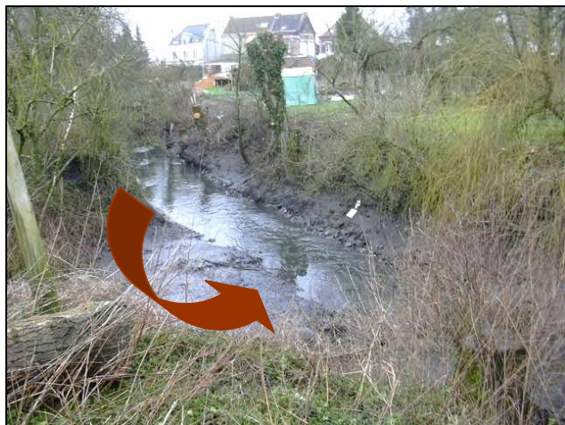
Photo 1 : Berges déstabilisées par glissement en rive gauche en amont immédiat des vis de Beuvry
